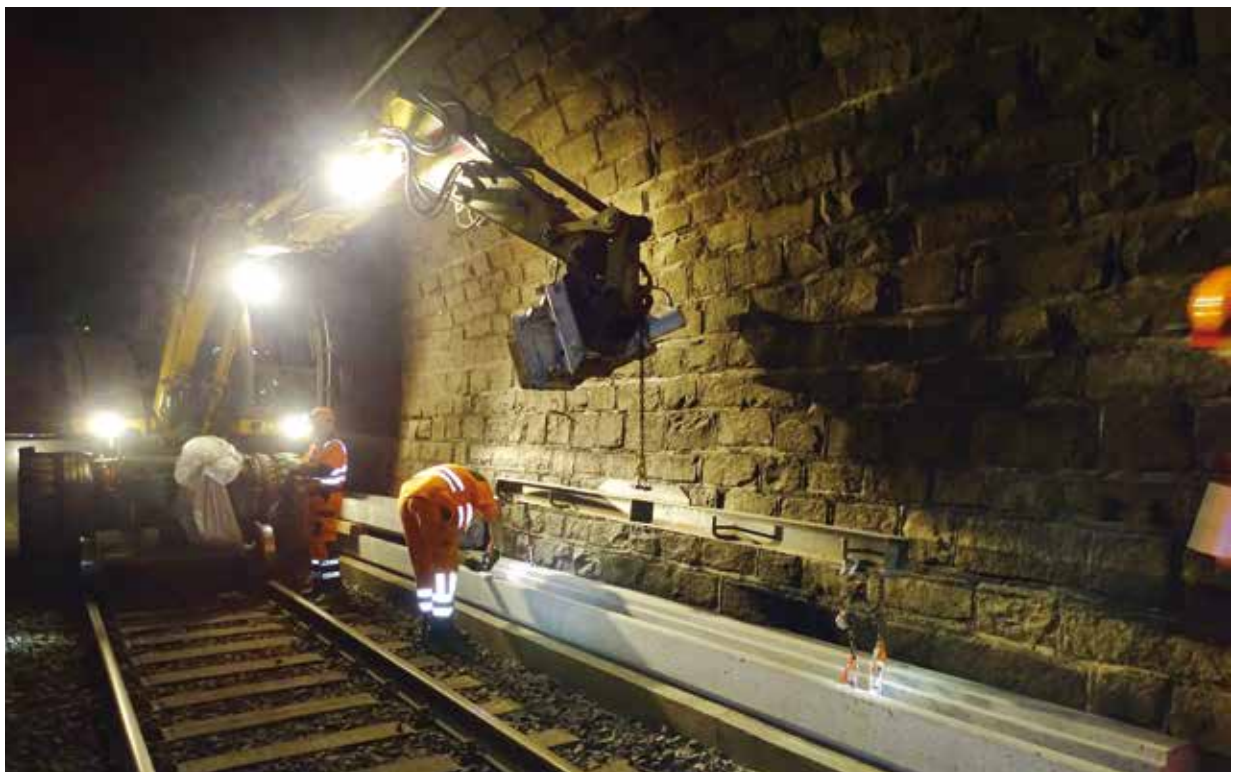
Bild 7: Einbau der Kabelrohr-Blöcke. Photo 7: Pose des tubes enrobés. Foto 7: impianto dei blocchi tubi.
