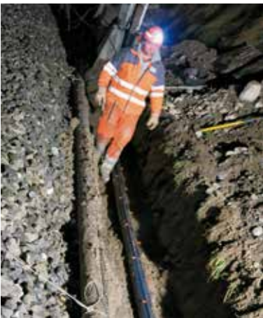
LV-Rohr mit fertig eingelegten Kabeln Tube à fermeture longitudinale avec câbles en état de fonctionnement Tubo a CL con cavo già introdotto
