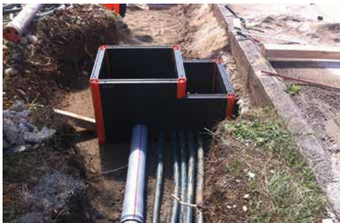
SYM-Box mit Kabelschutzrohren (Elektrizität und Kommunikation).
